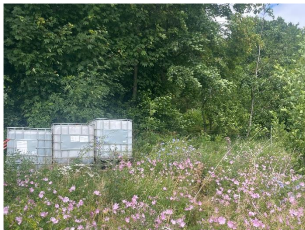
Figur 23 - Palletanke til regnvandsopsamling i Madhaven. Tankene er koblet til højskolens gymnastiksal, som høster store mængder vand. Palletankene står på det højeste punkt, så vandet kan fordeles passivt ved hjælp af tyngdekraften.
